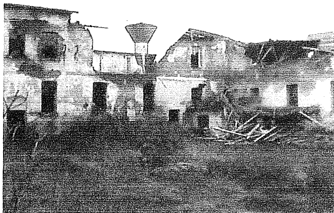
Clădire C1: Clădire industrială, tip P, an 1976, utilizată pentru activități de producție. Stare tehnică: structuri constructive parțial prăbușite, inclusiv acoperiș Pericol de demolare accidentală!
